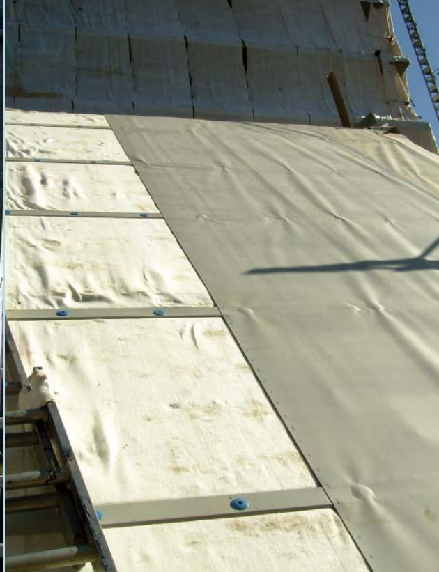
04| Pokládka první vrstvy hydroizolační fólie systému DUALDEK, stabilizace navařením na osнову kotvených poplastovaných plechů
