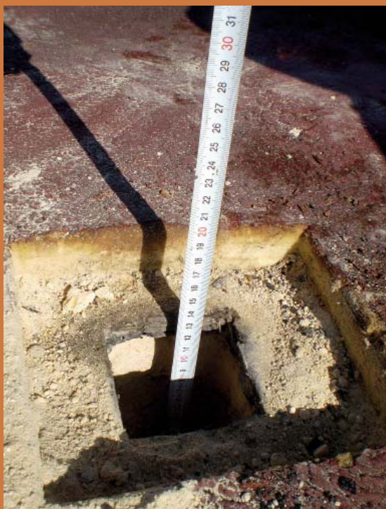
08 | Pod asfaltovými pásy byl násyp, pod ním betonová mazanina na stropní desce. Materiál ve skladbě byl vlhký
