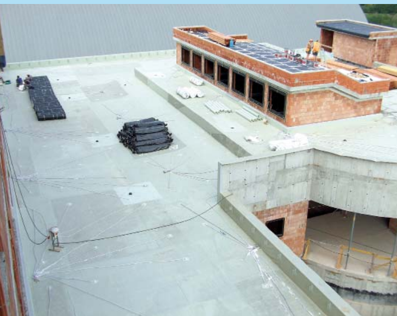
22 | Pohled na systém DUALDEK vč. hadic rozvedených po povrchu a sružených do míst budoucích kontrolních šachtic
