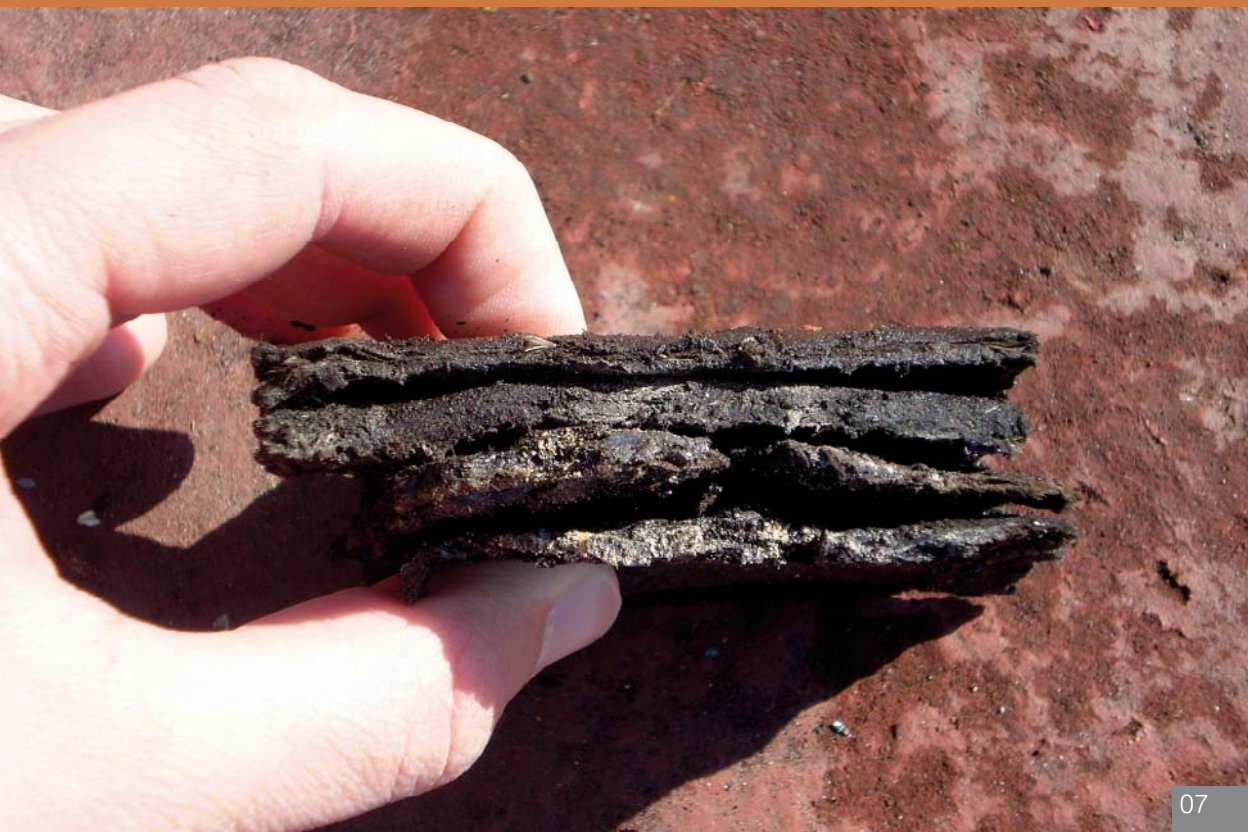
07| Pod PUR nástřikem zjištěno souvrství několika oxidovaných asfaltových pásů, jednotlivé vrstvy nespojitě
