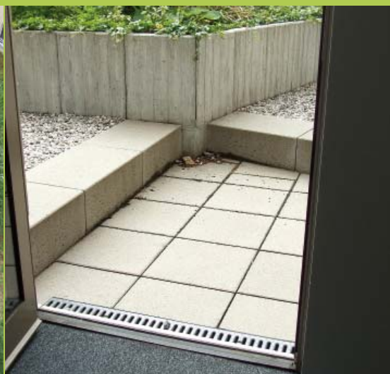
44| Stav v roce 2012. Práh vstupu z interiéru do střešní zahrady. Oblast pod dlažďenou plochou je odvodněna samostatným vtokem kvůli výškovým poměrům spádové vrstvy střechy.
