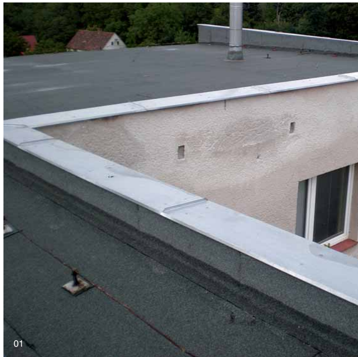
01 | Jednoplášťová střecha se spádovým násypem a kanálky z dutinových cihel. Na atice projevy vlhkosti akumulované v násypu.
