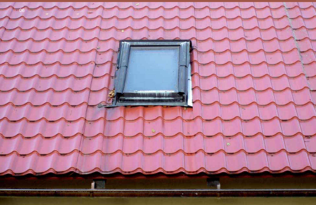
06| Nerovné umístění okna, boční lemování okna není pod krytinou, nepřípustné spodní rovné lemování navíc v levém dolním rohu bez vložení do vodorovného spoje tabulí.
