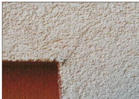
Následky absence diagonální výztuže
