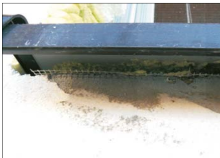
Nekvalitní montáž parapetního plechu – nedostatečná fixace, netěsnost a vznik tepelného mostu
