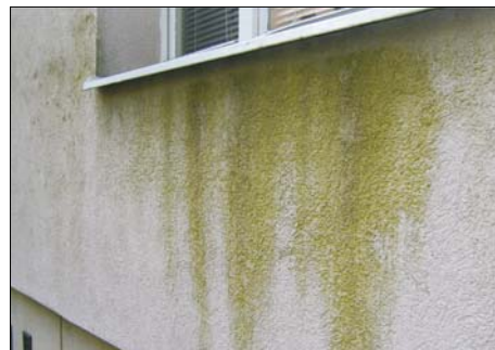
Následky nekvalitní montáže parapetního plechu – kondenzace vody na spodním líci plechu = stálý přísun vody a růst řas
