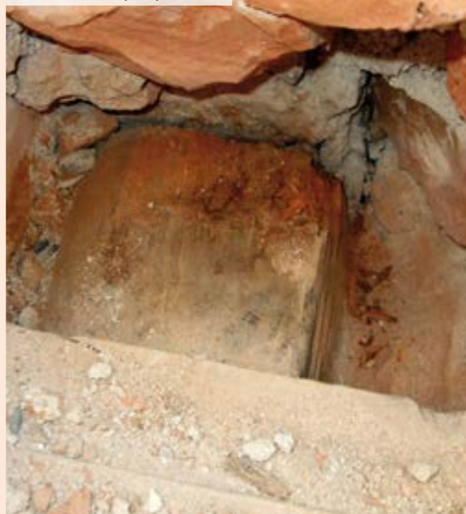
02 | Záhlavie trámu vyžadujúce sanáciu
