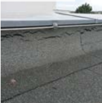
01 | Poškodený povrch asfaltovaného pásu na atike
