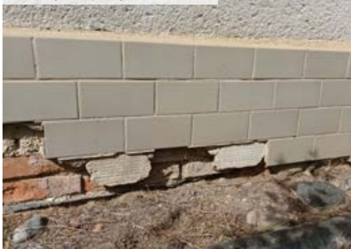
01 | Pôvodný stav, odpadávajúci obklad sokla domu
