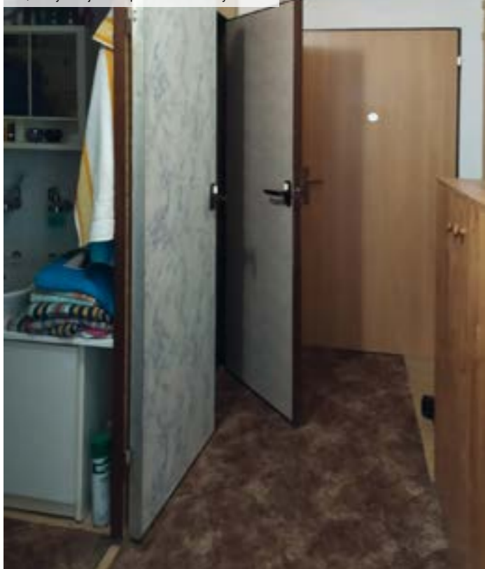
01 | Nevyhovujúca dispozícia interiérových dverí
