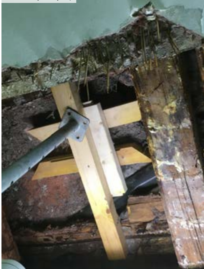
01 | Poškodený trámový strop
