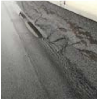
02 | Poškodený povrch asfaltovaného pásu na stene svetlíka
