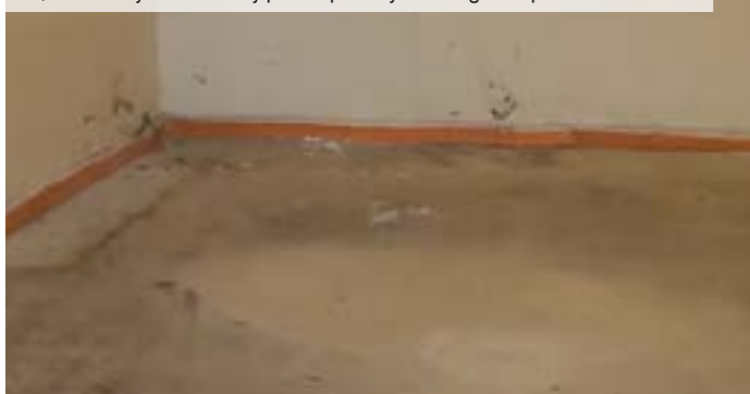
01 | Znečistený a nevzhľadný povrch podlahy a sokla garáže pred rekonštrukciou
