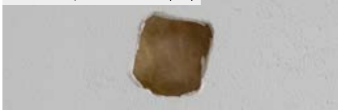
01 | Poškodené opláštenie sadrokartónovej steny
