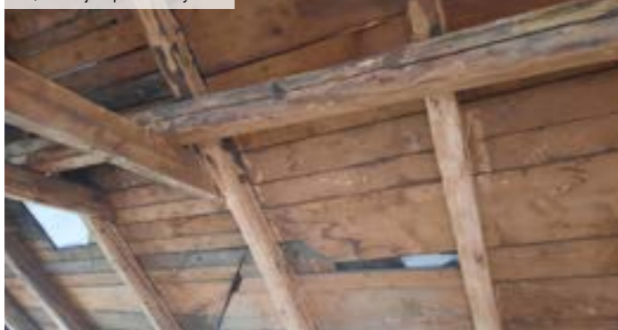
01 | Existujúci poškodený krov
