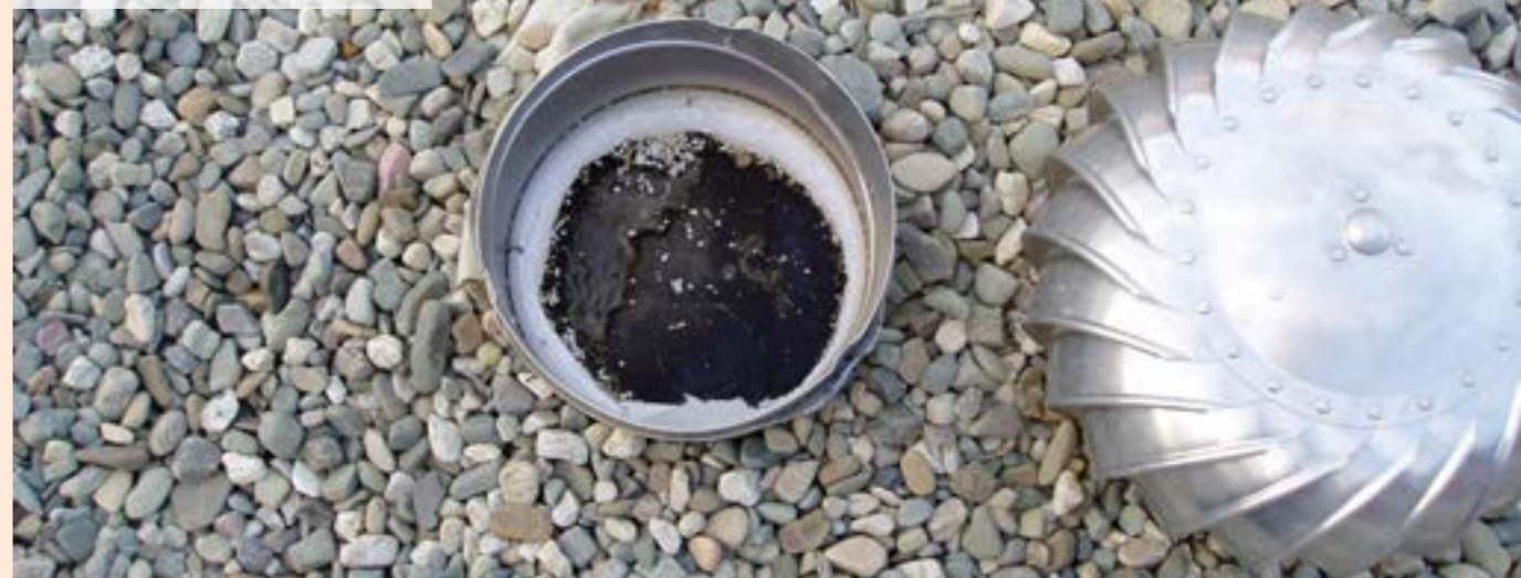
05 | Pohľad do otvoreného komína a viditeľná voda v skladbe strešného plášťa
