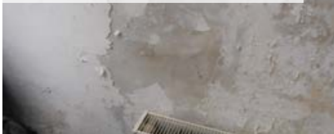
01 | Stav muriva pred rekonštrukciou. Prejavom vzlianjúcej vlhkosti je vlhká omietka, odpadávajúca maľba, solné výkveti, pocit zatuchliny v miestnosti.
