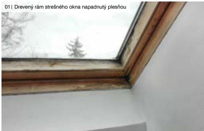
01 | Drevený rám strešného okna napadnutý plesňou
