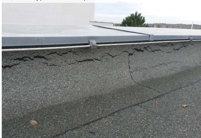
01 | Poškozený povrch asfaltového pásu na atice
