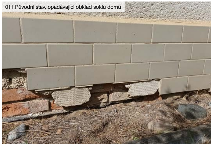
01 | Původní stav, opadávající obklad soklu domu
