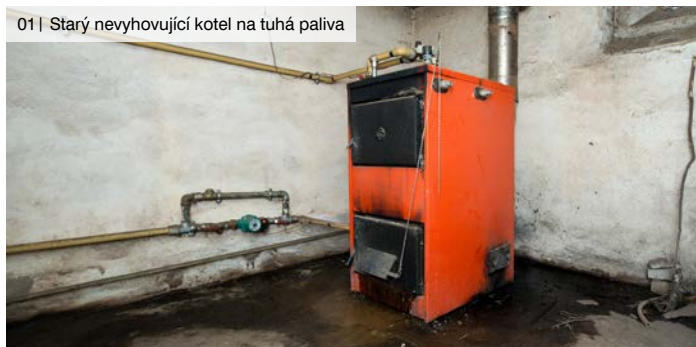
01 | Starý nevyhovující kotel na tuhá paliva
