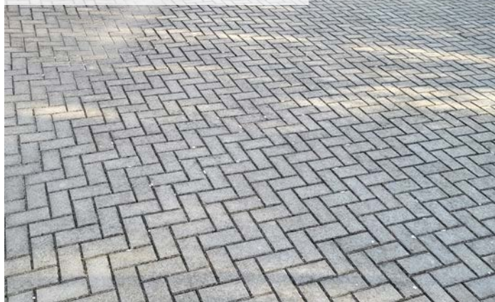
01 | Původní nerovná a nevzhledná betonová dlažba
