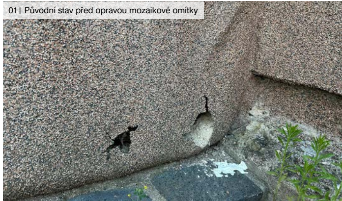
01 | Původní stav před opravou mozaikové omítky
