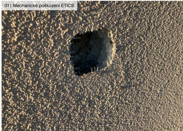
01 | Mechanické poškození ETICS
