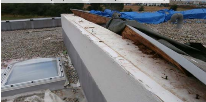
01_02 | Defekt koruny atiky z důvodu vlhkostí degradované OSB desky
