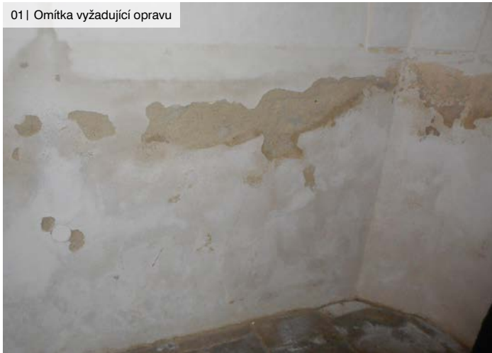
01 | Omítka vyžadující opravu
