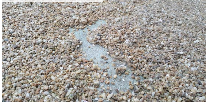
01 | Původní stav před sanací konstrukce
