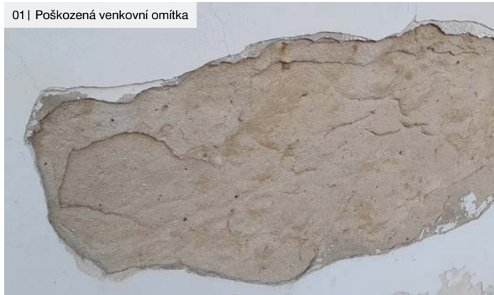
01 | Poškozená venkovní omítka
