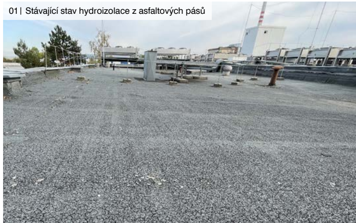
01 | Stávající stav hydroizolace z asfaltových pásů
