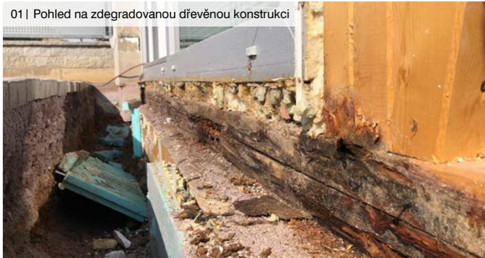
01 | Pohled na zdegradovanou dřevěnou konstrukci
