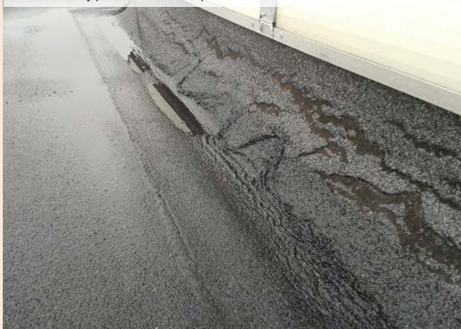
02 | Poškozený povrch asfaltového pásu na stěně světlíku
