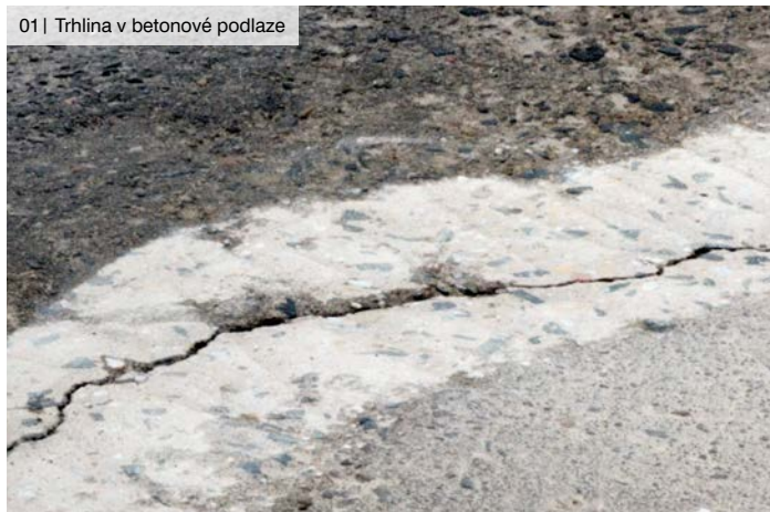
01 | Trhlina v betonové podlaze
