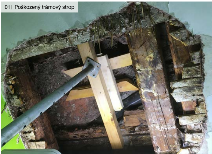
01 | Poškozený trámový strop
