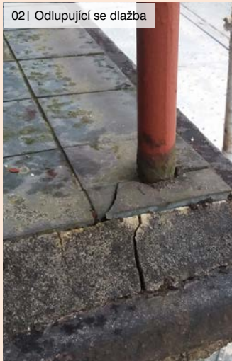
02 | Odlupující se dlažba
