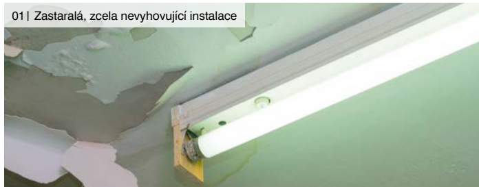
01 | Zastaralá, zcela nevyhovující instalace
