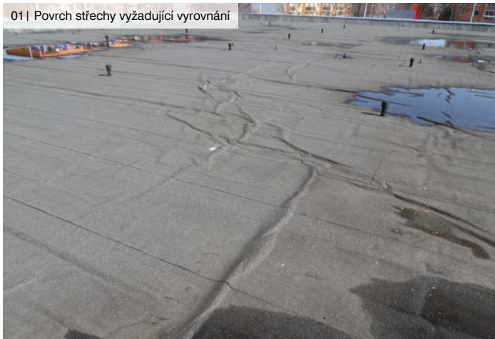
01 | Povrch střechy vyžadující vyrovnání
