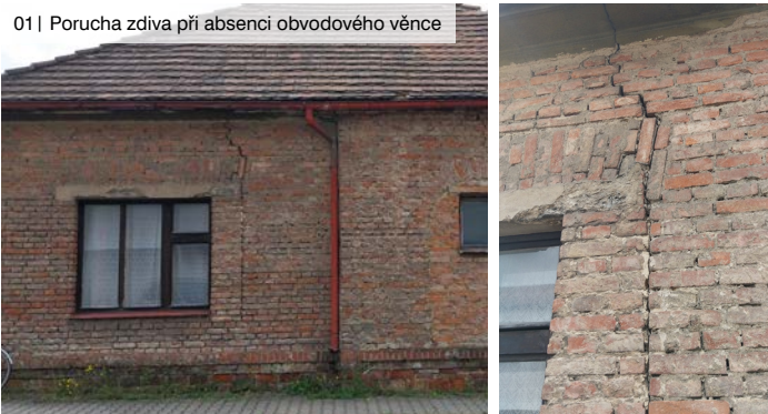
01 | Porucha zdiva při absenci obvodového věnce
