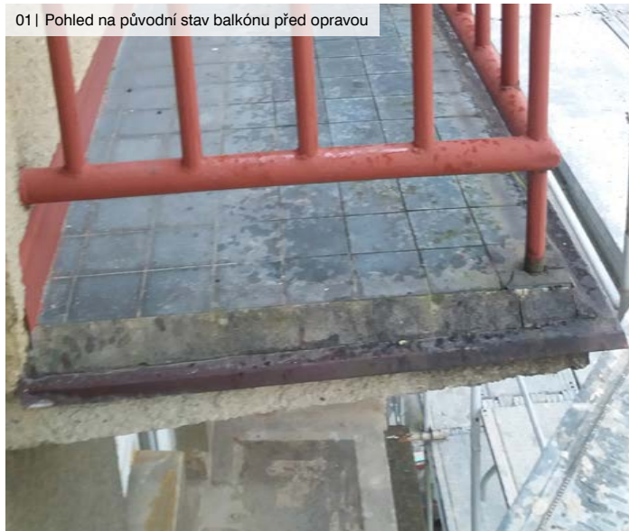
01 | Pohled na původní stav balkónu před opravou
