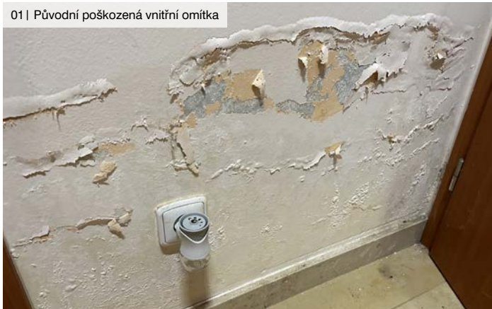
01 | Původní poškozená vnitřní omítka
