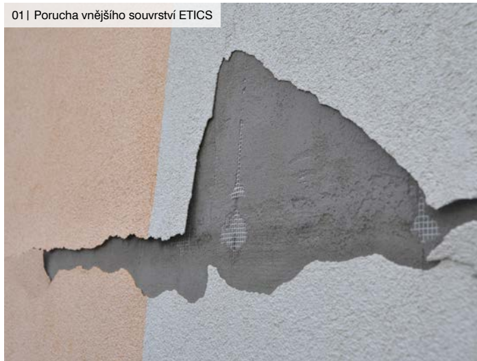
01 | Porucha vnějšího souvrství ETICS
