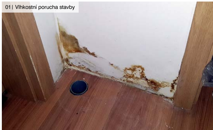
01 | Vlhkostní porucha stavby
