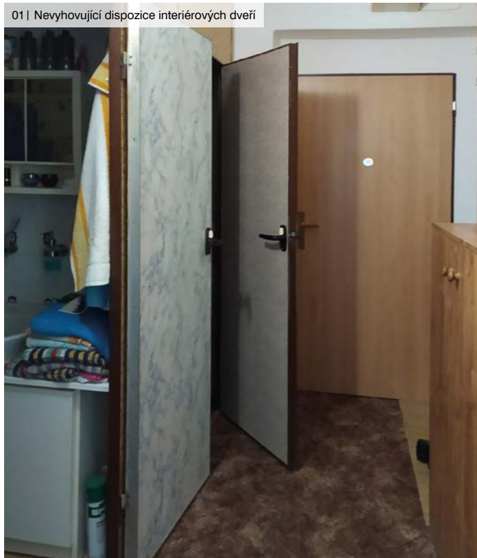
01 | Nevyhovující dispozice interiérových dveří
