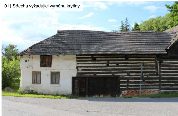
01 | Střecha vyžadující výměnu krytiny
