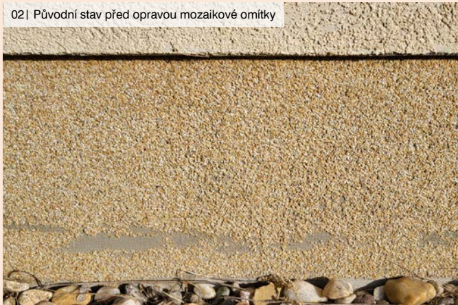
02 | Původní stav před opravou mozaikové omítky
