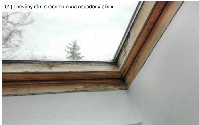
01 | Dřevěný rám střešního okna napadený plísní
