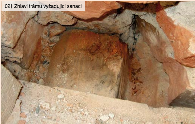
02 | Zhlaví trámu vyžadující sanaci
