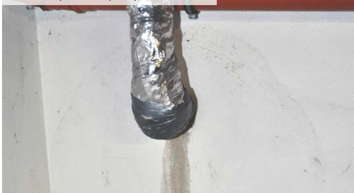
01 | Netěsné provedení u prostupu stěnou suterénu
