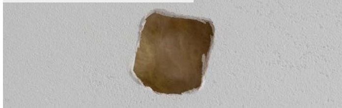
01 | Poškozené opláštění sádrokartonové stěny
