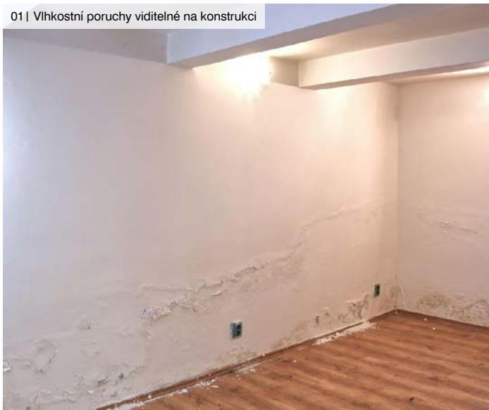
01 | Vlhkostní poruchy viditelné na konstrukci
