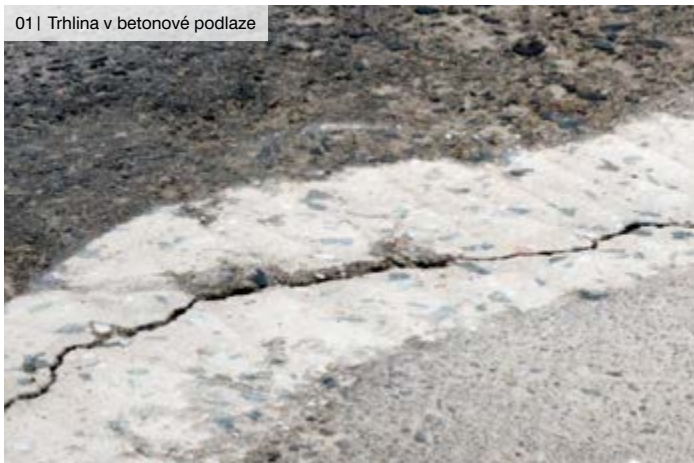
01 | Trhlina v betonové podlaze
