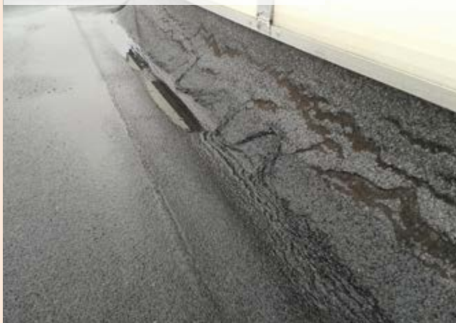
02 | Poškozený povrch asfaltového pásu na stěně světlíku
