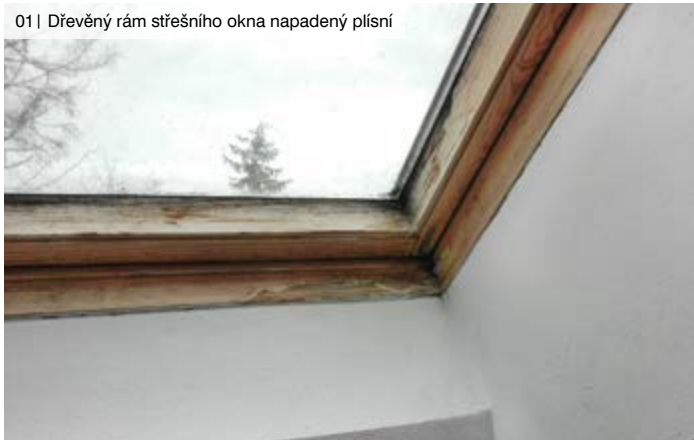
01 | Dřevěný rám střešního okna napadený plísní
