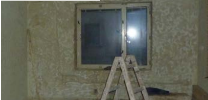
01 | Původní otvor, který je nutno zvětšit
