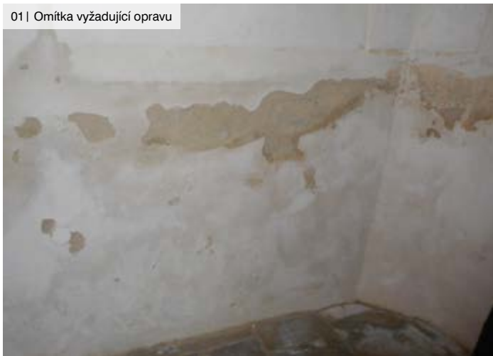
01 | Omítka vyžadující opravu
