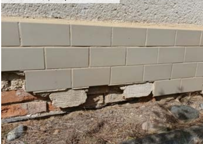
01 | Původní stav, opadávající obklad soklu domu
