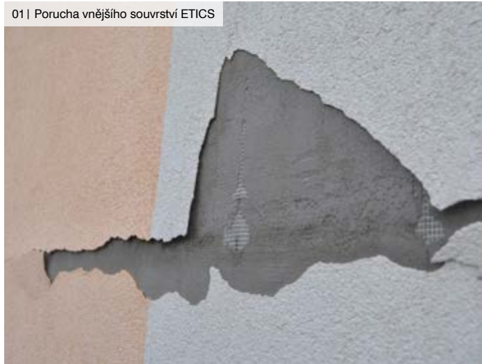
01 | Porucha vnějšího souvrství ETICS
