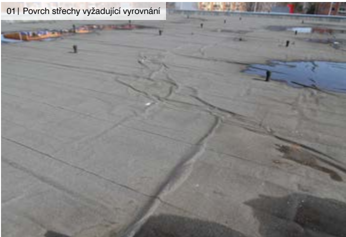
01 | Povrch střechy vyžadující vyrovnání
