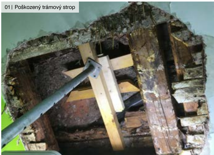
01 | Poškozený trámový strop
