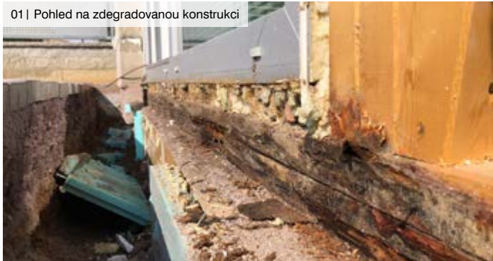
01 | Pohled na zdegradovanou konstrukci
