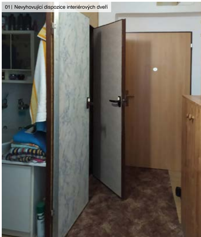
01 | Nevyhovující dispozice interiérových dveří
