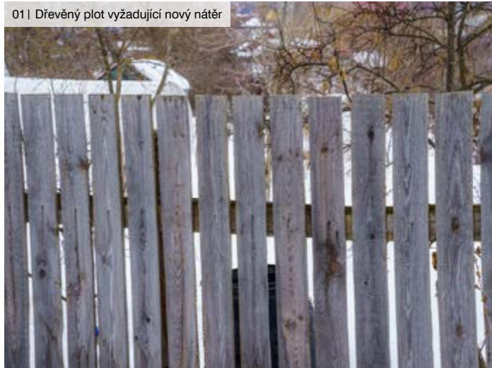
01 | Dřevěný plot vyžadující nový nátěr
