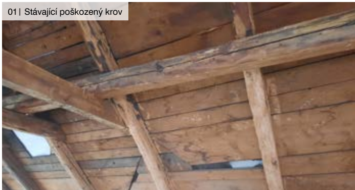
01 | Stávající poškozený krov
