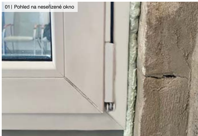
01 | Pohled na neseřízené okno
