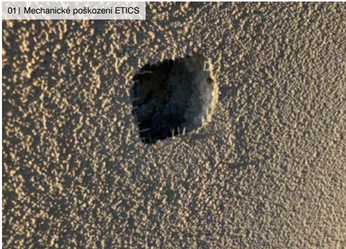
01 | Mechanické poškození ETICS
