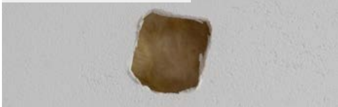
01 | Poškozené opláštění sádrokartonové stěny
