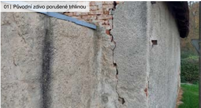
01 | Původní zdivo porušené trhlinou
