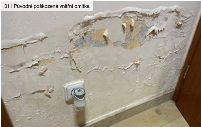
01 | Původní poškozená vnitřní omítka
