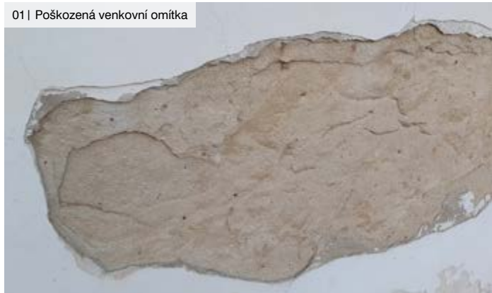
01 | Poškozená venkovní omítka
