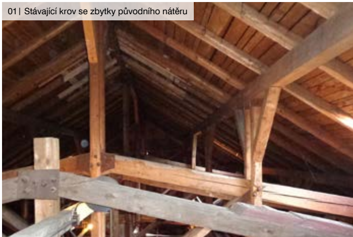
01 | Stávající krov se zbytky původního nátěru
