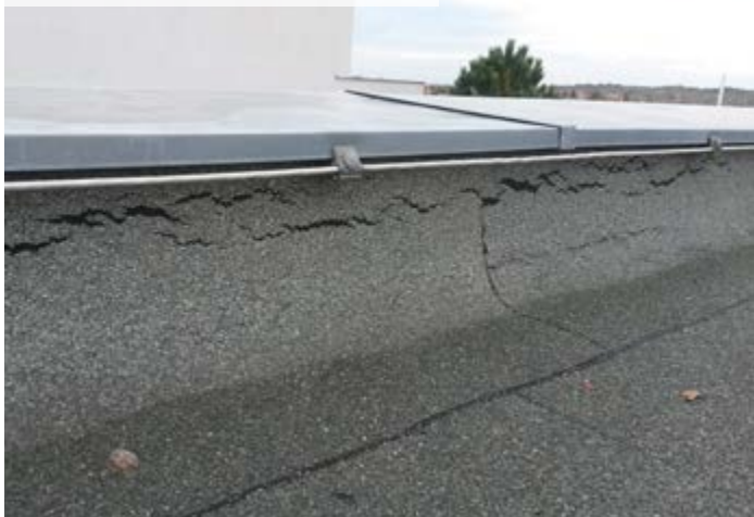
01 | Poškozený povrch asfaltového pásu na atice
