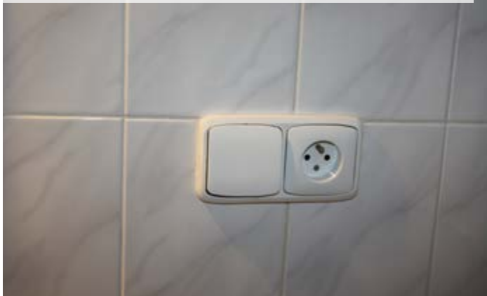
01 | Klasická elektroinstalace. Vypínače a zásuvky bez možnosti dálkového ovládání
