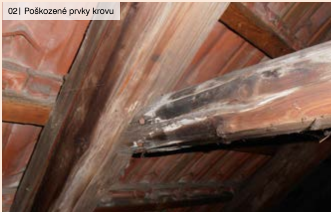
02 | Poškozené prvky krovu
