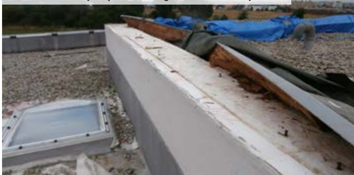
01_02 | Defekt koruny atiky z důvodu degradované OSB desky vlhkostí
