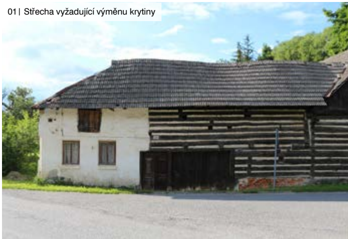
01 | Střecha vyžadující výměnu krytiny
