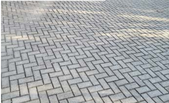
01 | Původní nerovná a nevzhledná betonová dlažba
