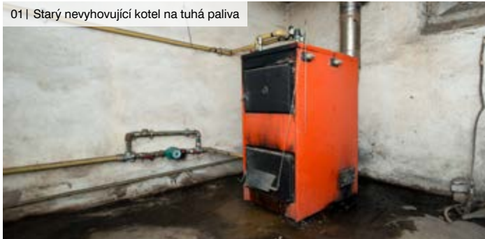
01 | Starý nevyhovující kotel na tuhá paliva
