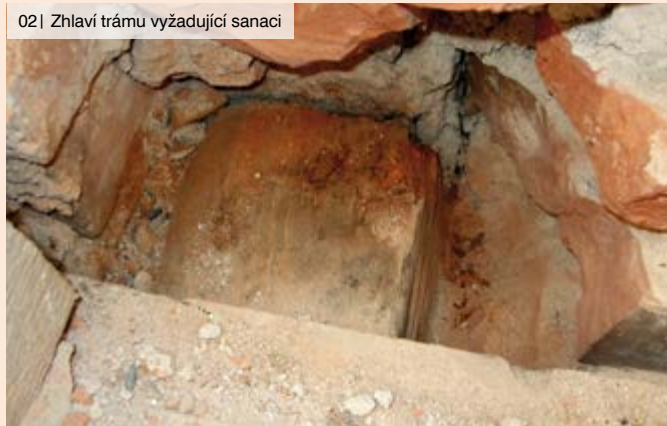
02 | Zhlaví trámu vyžadující sanaci
