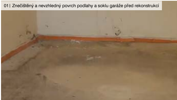
01 | Znečištěný a nevzhledný povrch podlahy a soklu garáže před rekonstrukcí
