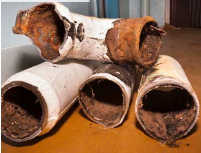
01 | Pohled na staré odpadní potrubí
