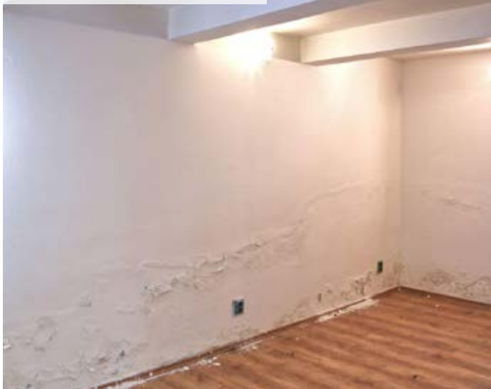
01 | Vlhkostní poruchy viditelné na konstrukci
