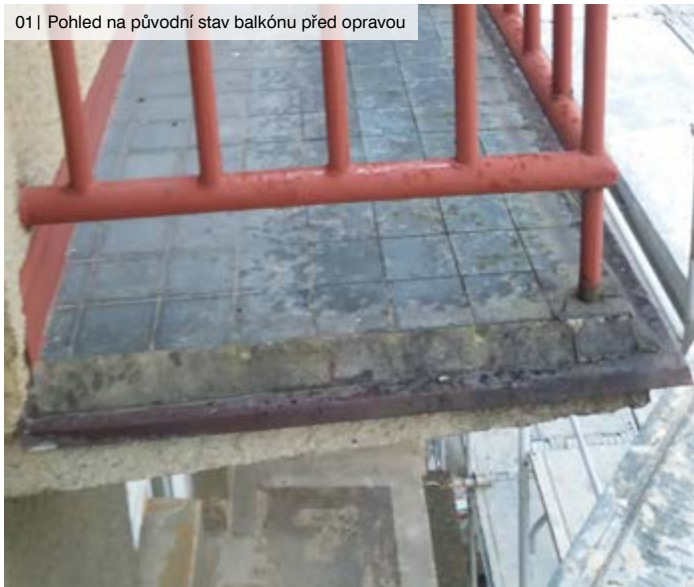
01 | Pohled na původní stav balkónu před opravou
