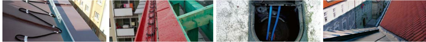
okraj střechy okapový žlab zemní vpust úžlabí střešní vpust střešní světlík atypický světlík hranatý žlab
