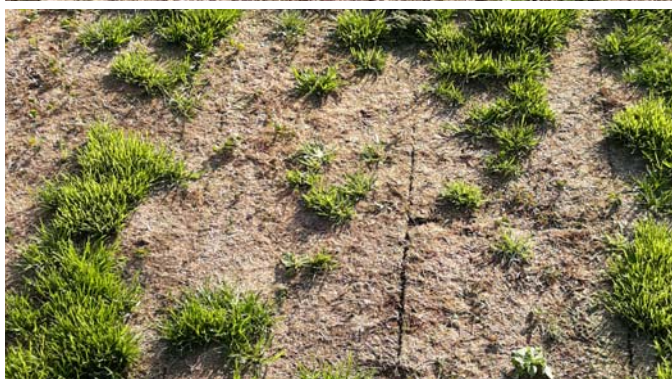
Poškozená rohož rozchodníku (nahore) a poškozený travní koberec (dole) z důvodu nedostatečného zavodnění skladby při založení vegetace a nevhodném období pokládky
