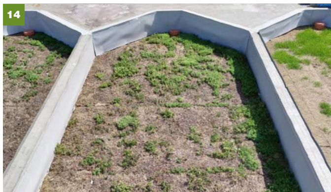
Následek nedostatečné zálivky při založení rozchodníkových rohoží
