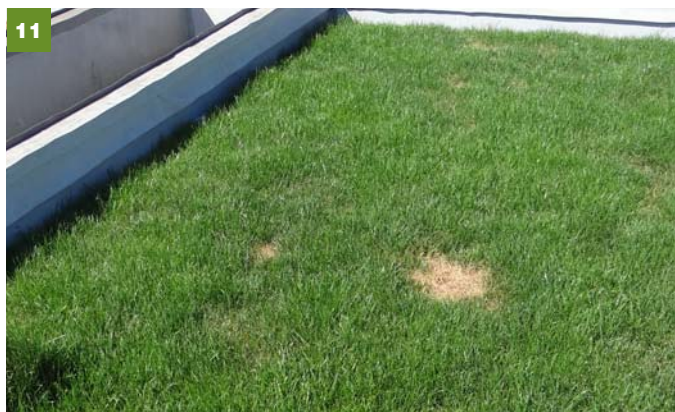
11 Spálené místo trávniku vegetační střechy z důvodu přehnojení
