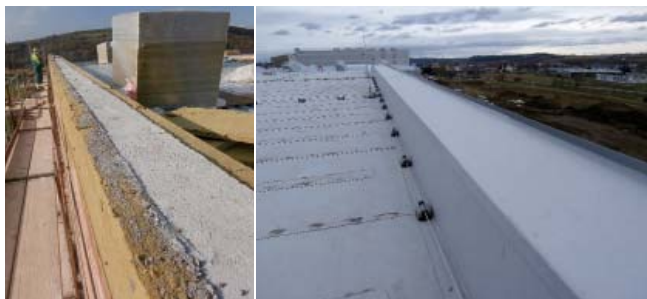
07| Ukončení hydroizolace na štítové stěně s ukázkou její finální podoby na střeše
