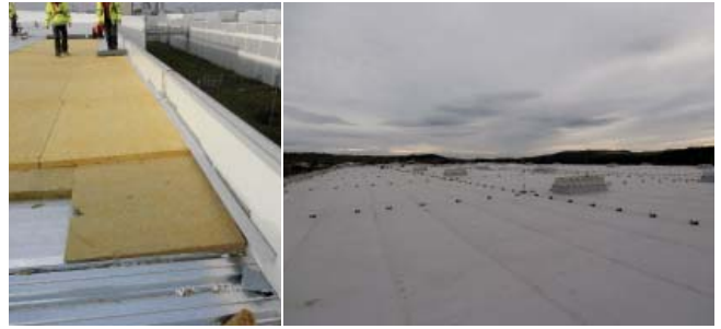
09| Ukončení hydroizolace na zateplených obvodových panelech Kingspan s ukázkou její finální podoby na střeše
