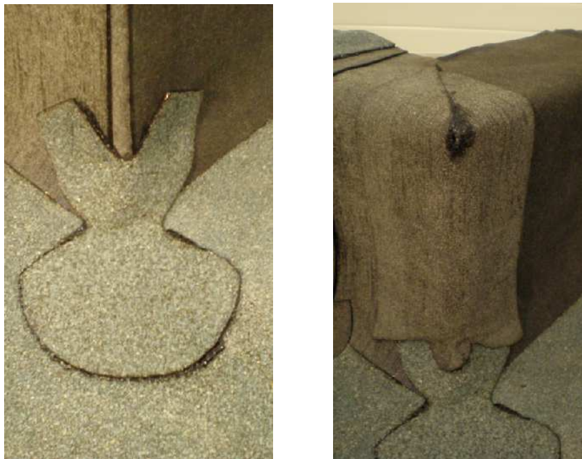
Obrázok /12/ Natavenie univerzálnej tvarovky 3 s posypem a univerzálnej tvarovky 4 bez posypu (pri nedokonalom tvare podkladu vonkajšieho rohu doporučujeme použiť univerzálnu tvarovku 4 s posypom pre uľahčenie napojenia rohových tvaroviek 2a a 2b)
