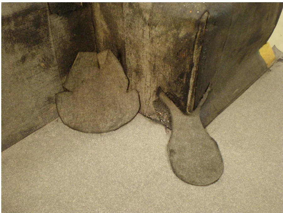
Obrázok /15/ Natavenie univerzálnych tvaroviek 1 a 3 (bez posypu), asfaltovaný pás z plochy je privedený k detailu
