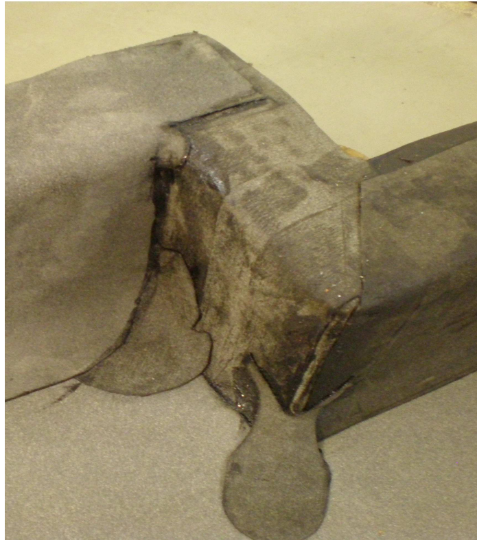
Obrázok /17/ Natavenie upraveného asfaltovaného pásu privedeného po atike k detailu vnútorného kúta
