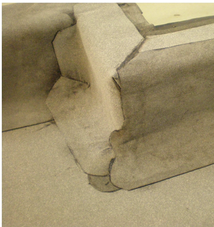
Obrázok /20/ Natavenie upraveného asfaltovaného pásu privedeného po atike k detailu vonkajšieho rohu
