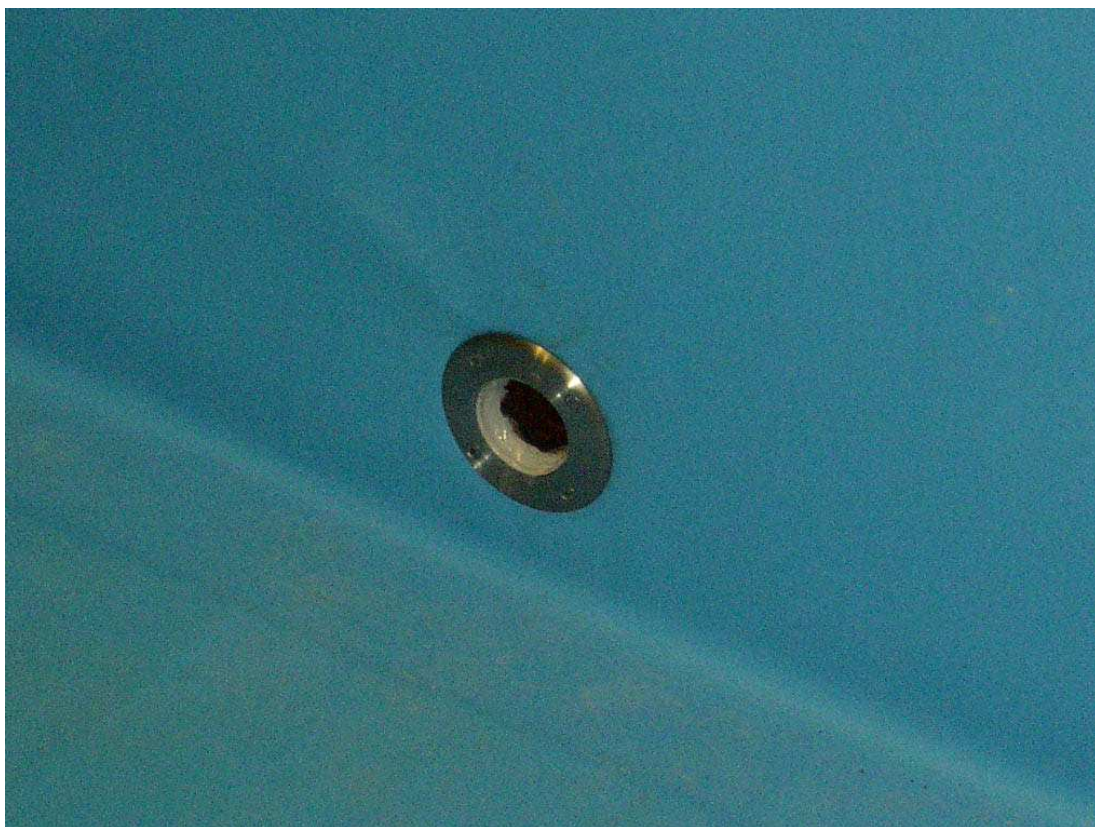
Foto 23. Verejný bazén Ústí nad Labem – privádzacia tryska.
