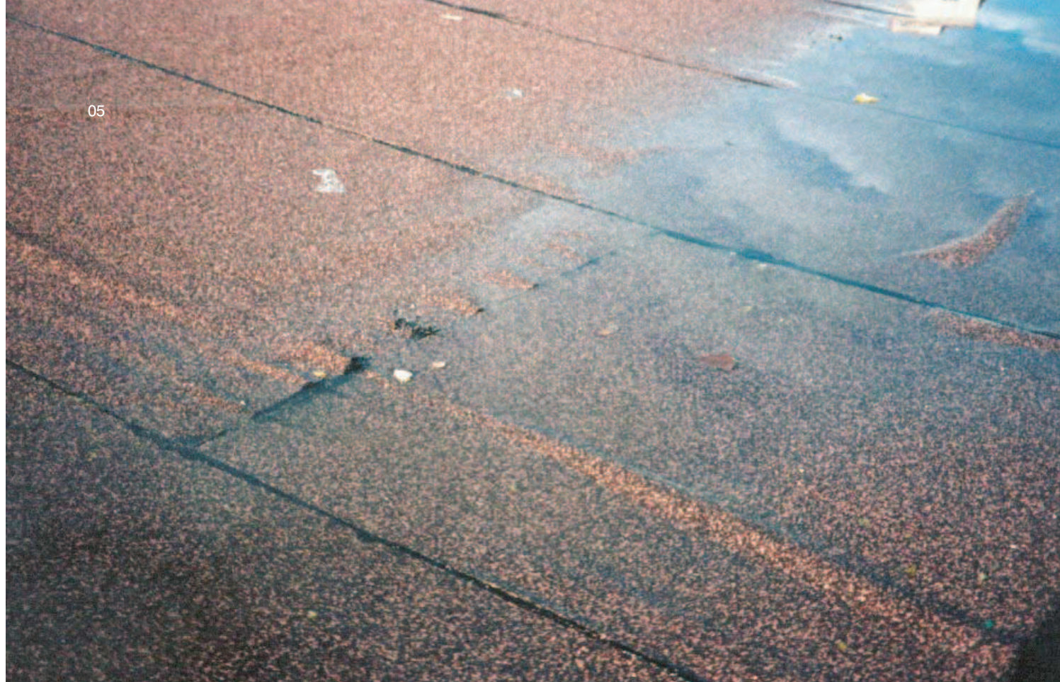
05| "Ujetý" pás v příčném spoji. Dotvarování způsobilo vlnky v přesahu pásu, vlnkami zatékalo. ČSN 73 0605-1 pro vrchní pásy hydroizolačních souvrství střech požaduje rozměrové změny nejvíce 0,3% stanovené podle ČSN EN 1107-1.
