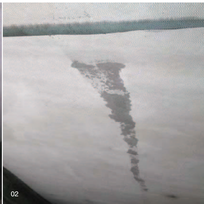
02 | Průsak po zkušebním nalití vody na fólii
