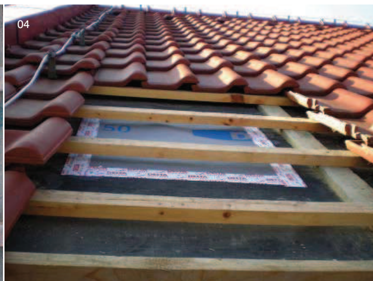
04 | vyspravená fólie v místě odběru
