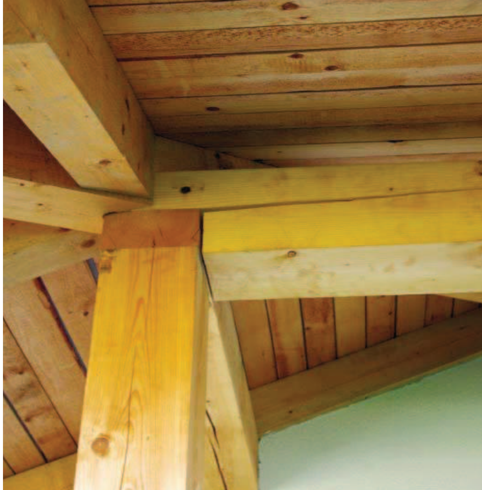
18| Výsušná trhlina ovlivňující únosnost vaznice
