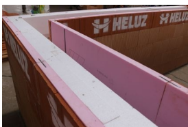
Tepelná izolace je položena, zkontroluje se těsnost styčných spár na vnitřní straně věnce
