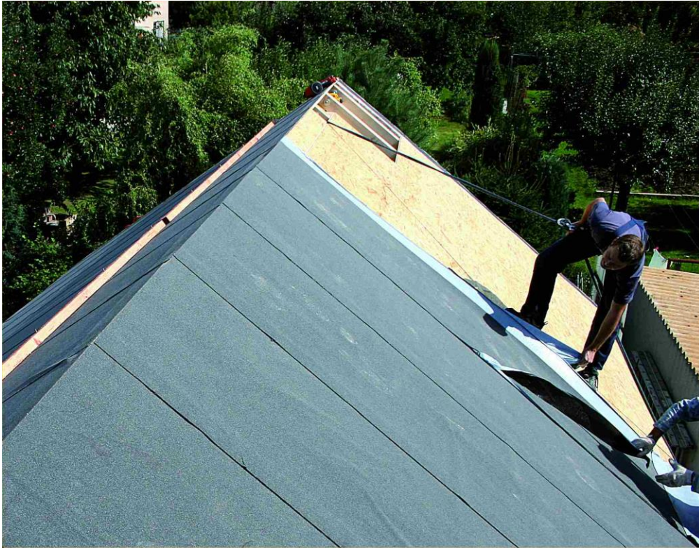
Obr 6. - Pokládka parotěsnicí a vzduchotěsnicí vrstvy ze samolepicího asfaltového pásu TOPDEK AL BARRIER
