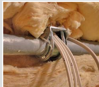
Navíc musí být u stožáru, který nese parabolou, provedeno pospojování.
