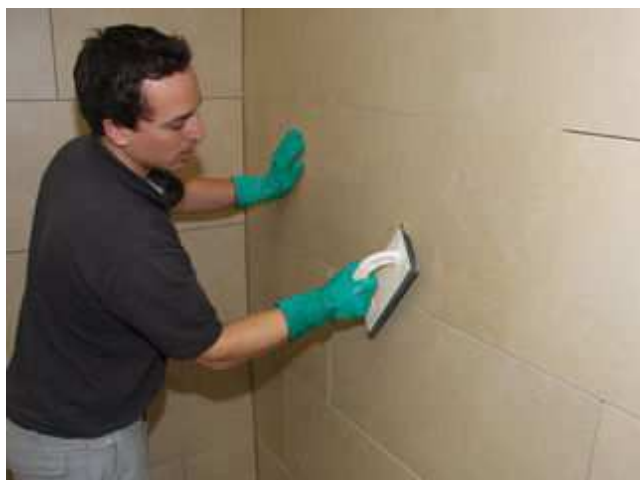
3. Spojení povrchu spárovací hmotou Sopro (např. Sopro DF 10 DesignFuge Flex, Sopro Brillant Perfuge)
