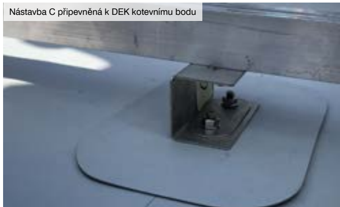
FVE s DEK kotevním systémem ve skladbě ploché střechy
