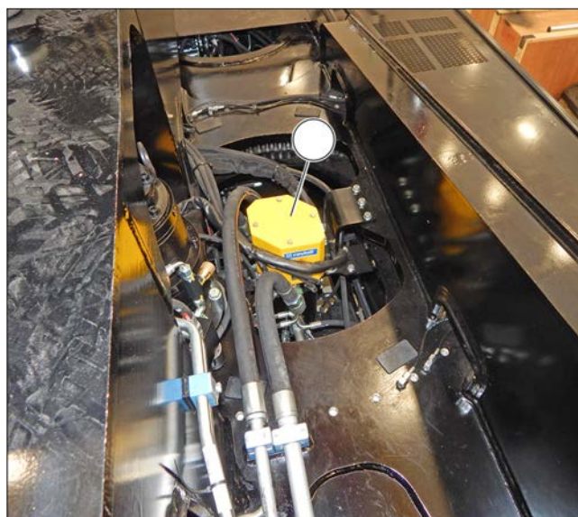
Obrázek 224: Kontrola a čištění kroužků vysílače otočného elektrického kolektoru
