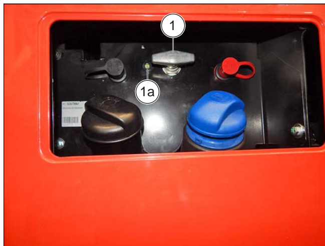
Obrázek 66: Odpojovací spínač akumulátoru
