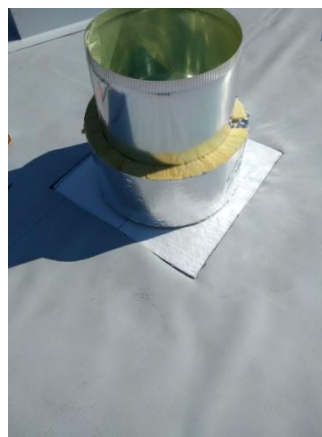
Krok 5 - vyskládání tepelné izolace přes střešní plášť a zateplení tubusu světlovodu do výšky střešní základny
