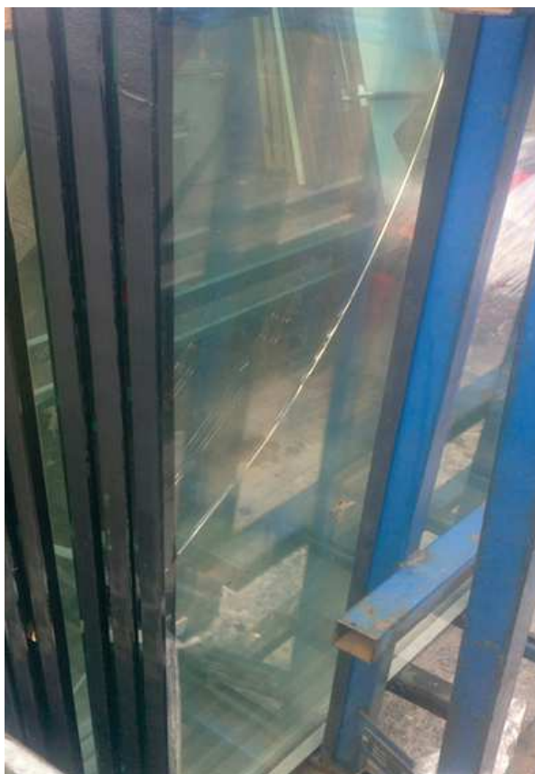
Obr. 20 – Poškozené zasklení okna na přepravní konstrukci
