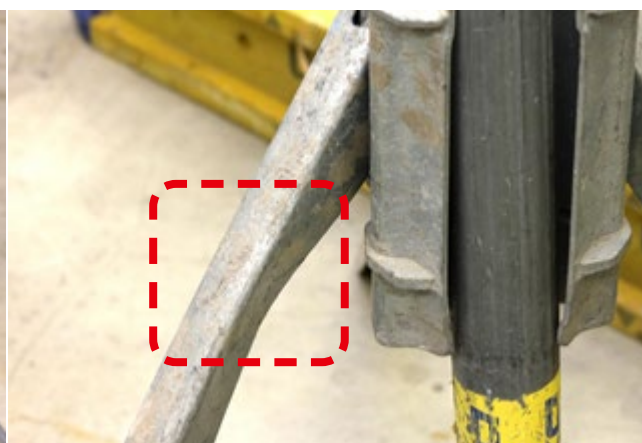
Trojnožky s chybějící či poškozenou nohou jsou nepřipustné. Takové trojnožky se nesmí používat k bednění.
