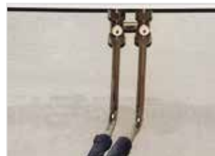
Instalace s připojovacími koleny
