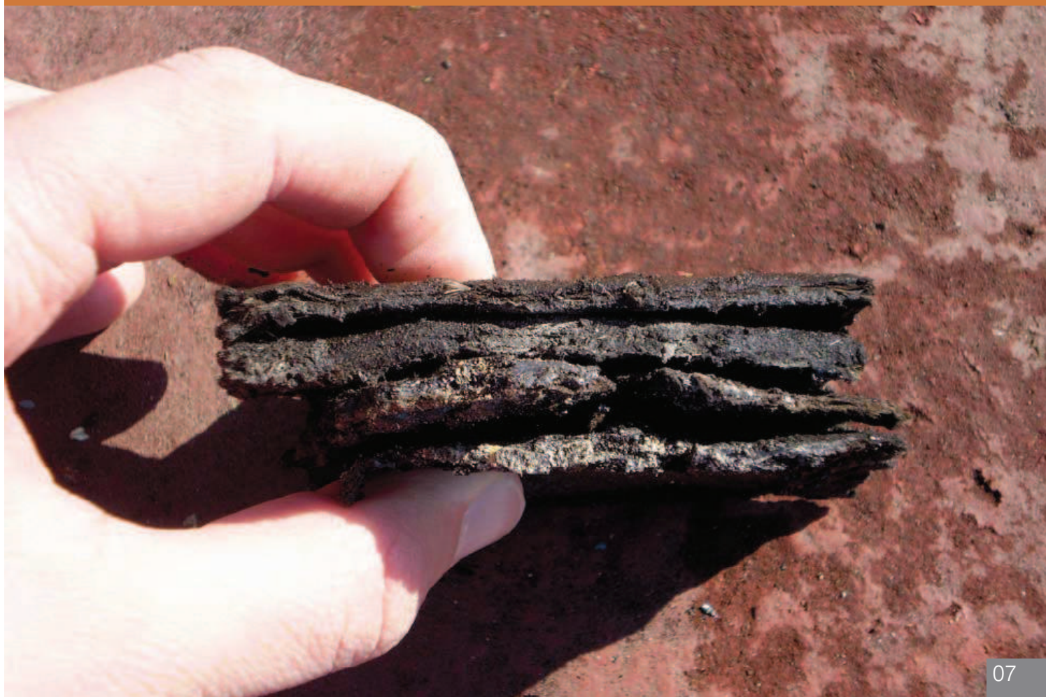
07| Pod PUR náštříkem zjištěno souvrství několika oxidovaných asfaltových pásů, jednotlivé vrstvy nespojitě
