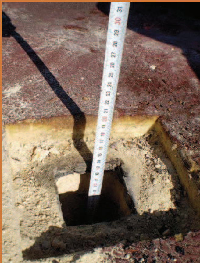
08| Pod asfaltovými pásy byl násyp, pod ním betonová mazanina na stropní desce. Materiál ve skladbě byl vlhký
