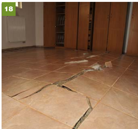
18| Deformace vrstev podlahy vztlakem vody proniklé do záspy stavební jámy
