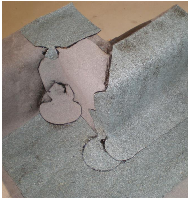
Obrázek /21/ Natavení upraveného asfaltového pásu s posypem přivedeného po atice k detailu vnějšího rohu
