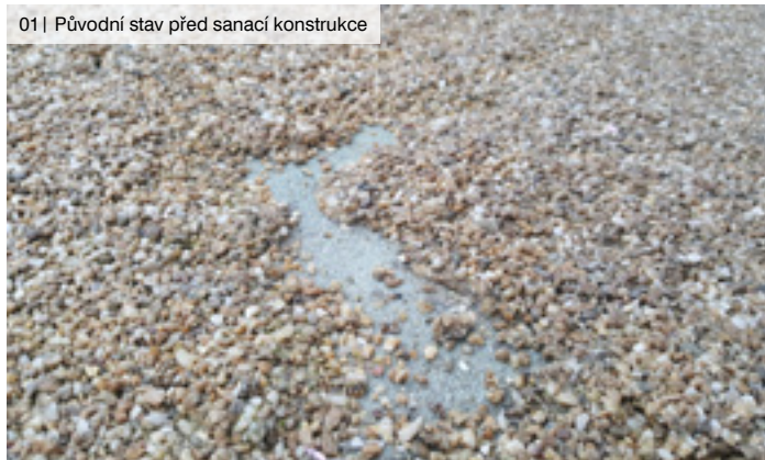
01 | Původní stav před sanací konstrukce
