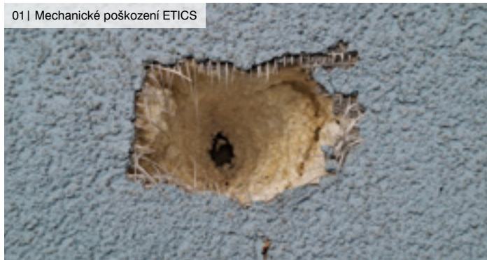
01 | Mechanické poškození ETICS
