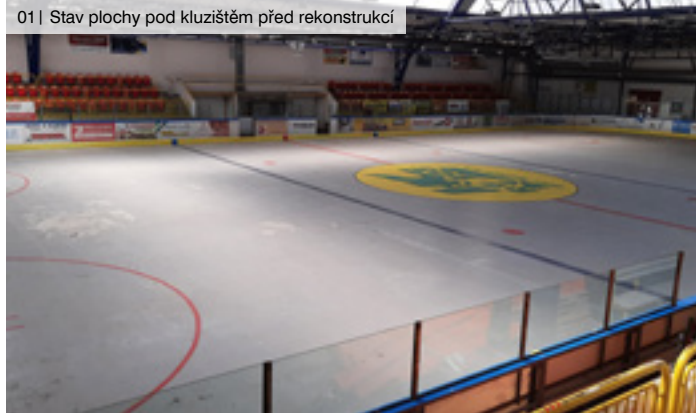
01 | Stav plochy pod kluzištěm před rekonstrukcí
