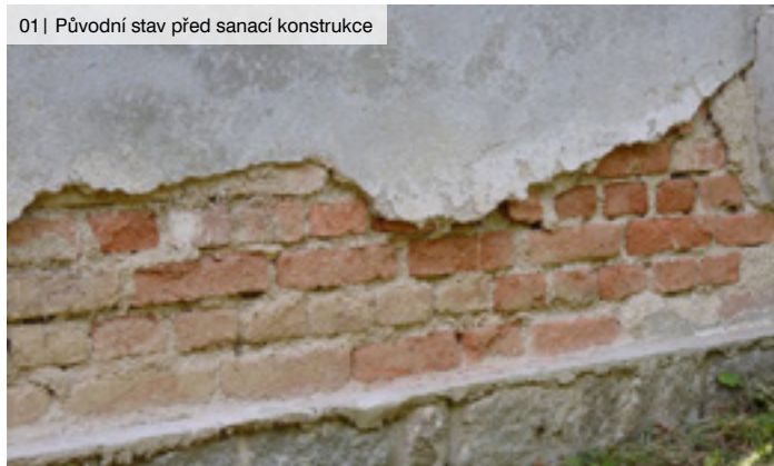
01 | Původní stav před sanací konstrukce
