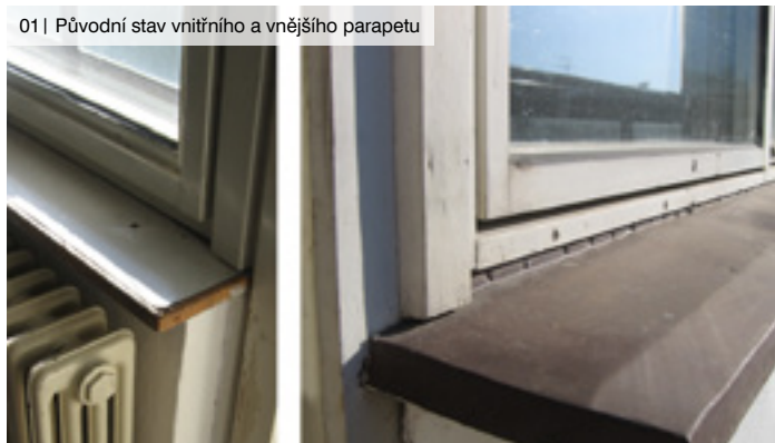
01 | Původní stav vnitřního a vnějšího parapetu
