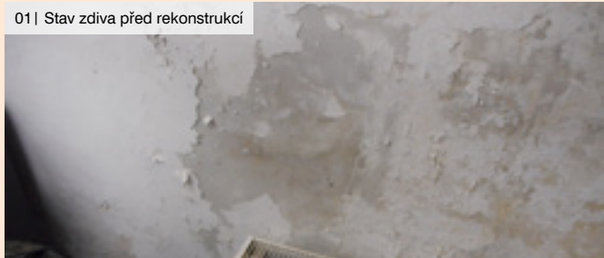
01 | Stav zdiva před rekonstrukcí
