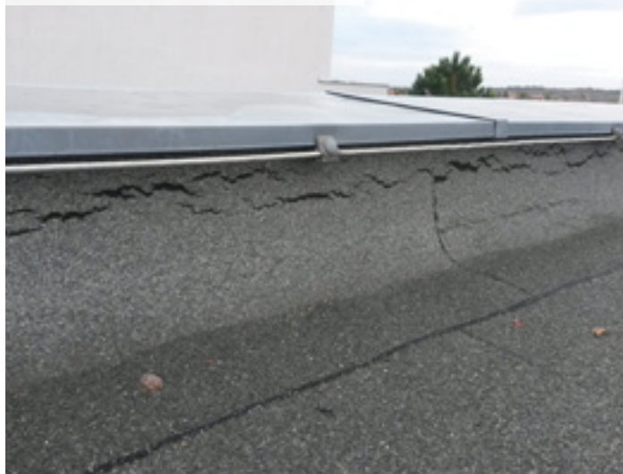
01 | Poškozený povrch asfaltového pásu na atice
