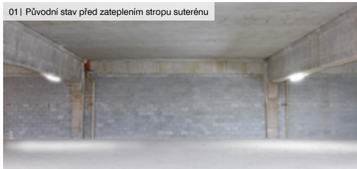
01 | Původní stav před zateplením stropu suterénu
