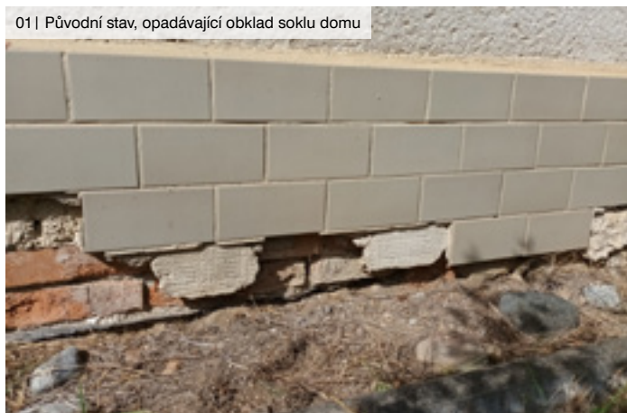
01 | Původní stav, opadávající obklad soklu domu
