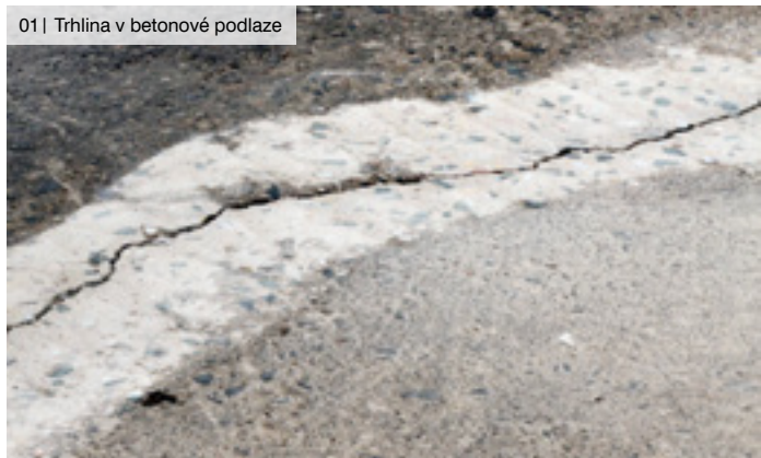
01 | Trhlina v betonové podlaze
