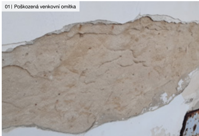
01 | Poškozená venkovní omítka
