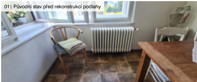
01 | Původní stav před rekonstrukcí podlahy
