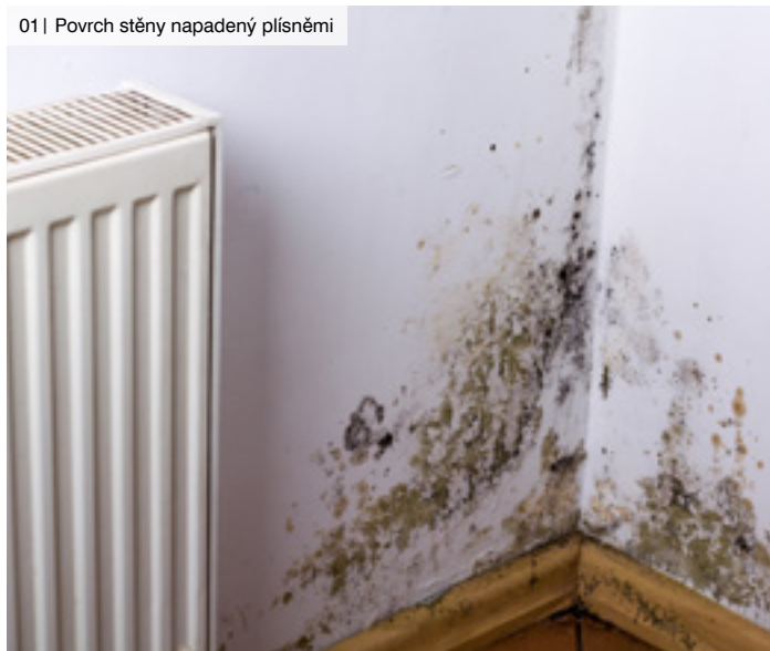
01 | Povrch stěny napadený plísněmi
