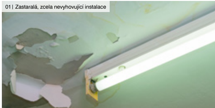
01 | Zastaralá, zcela nevyhovující instalace
