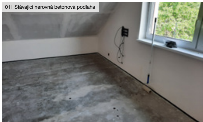
01 | Stávající nerovná betonová podlaha
