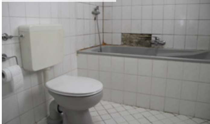
01 | Stará koupelna s popraskaným obkladem
