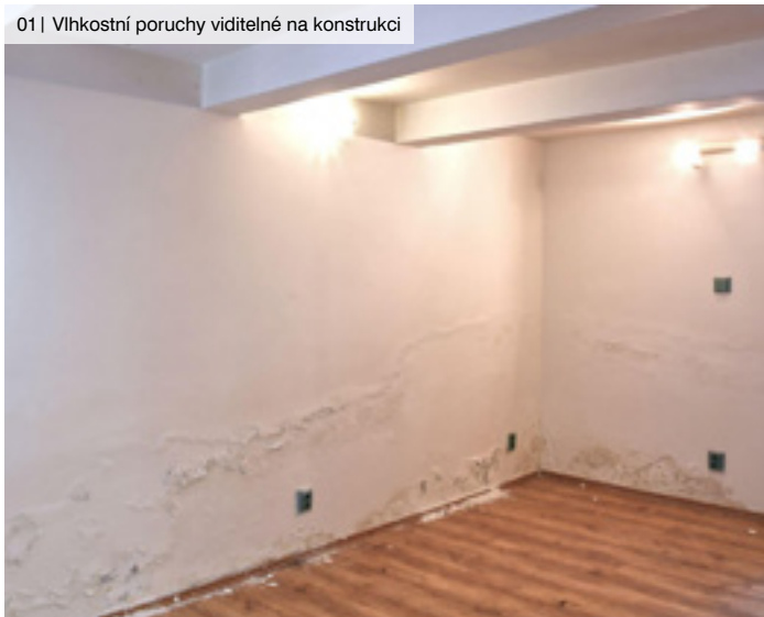
01 | Vlhkostní poruchy viditelné na konstrukci
