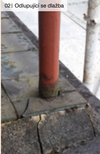
02 | Odlupující se dlažba
