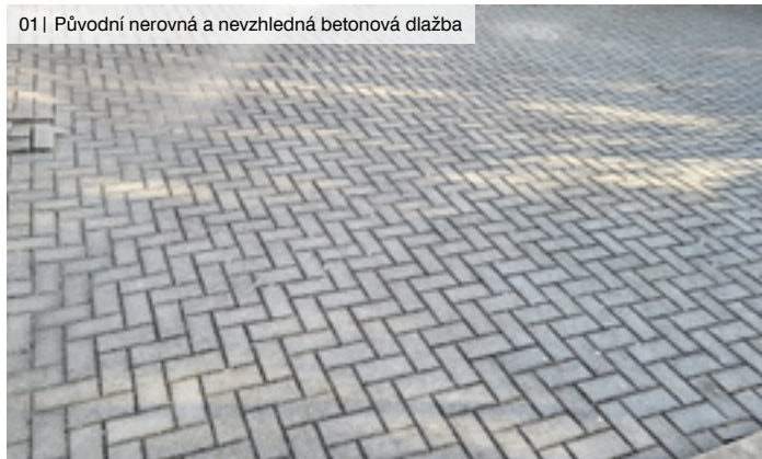
01 | Původní nerovná a nevzhledná betonová dlažba
