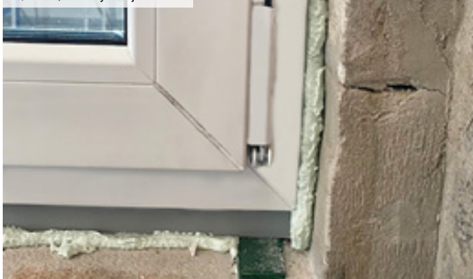
01 | Okno, které vyžaduje seřízení
