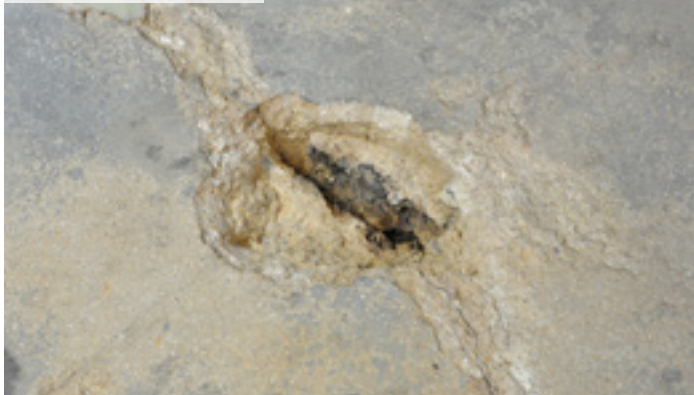
01 | Výtluk v betonové podlaze
