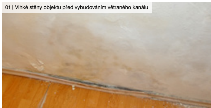
01 | Vlhké stěny objektu před vybudováním větraného kanálu
