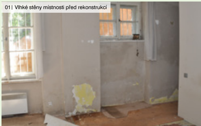
01 | Vlhké stěny místnosti před rekonstrukcí
