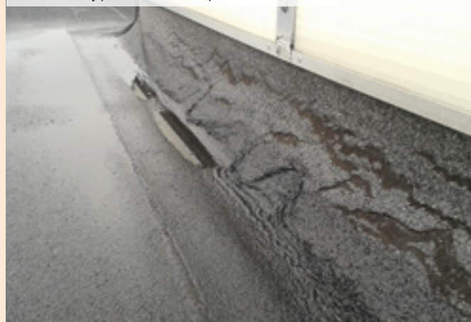
02 | Poškozený povrch asfaltového pásu na stěně světlíku
