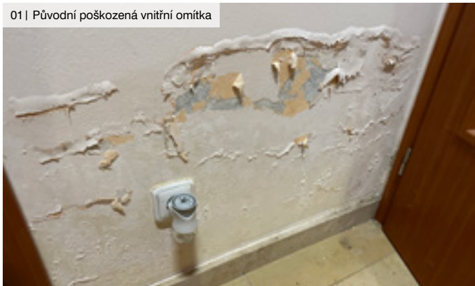
01 | Původní poškozená vnitřní omítka
