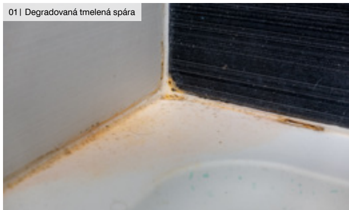
01 | Degradovaná tmelená spára
