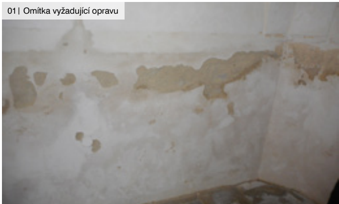
01 | Omítka vyžadující opravu
