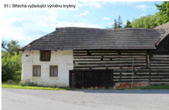
01 | Střecha vyžadující výměnu krytiny
