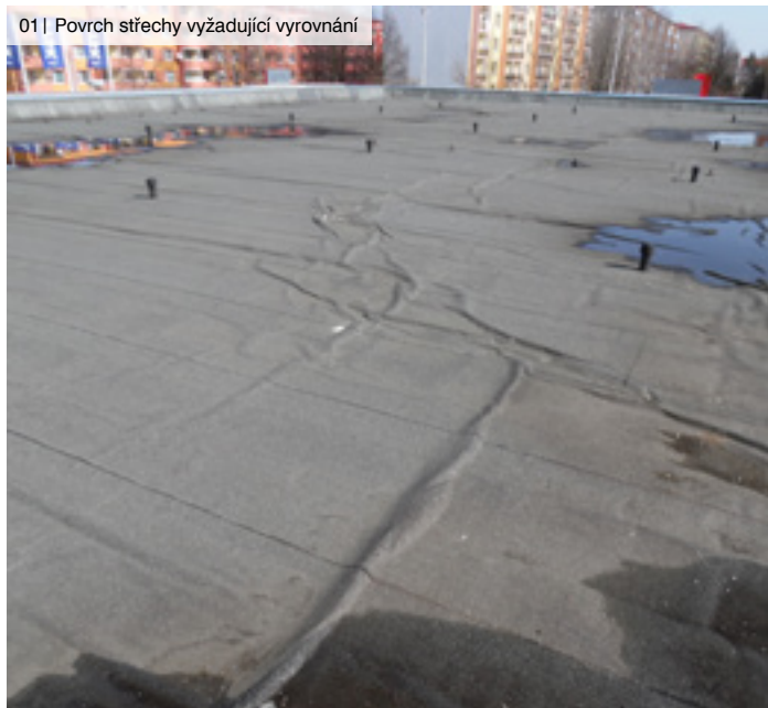
01 | Povrch střechy vyžadující vyrovnaní
