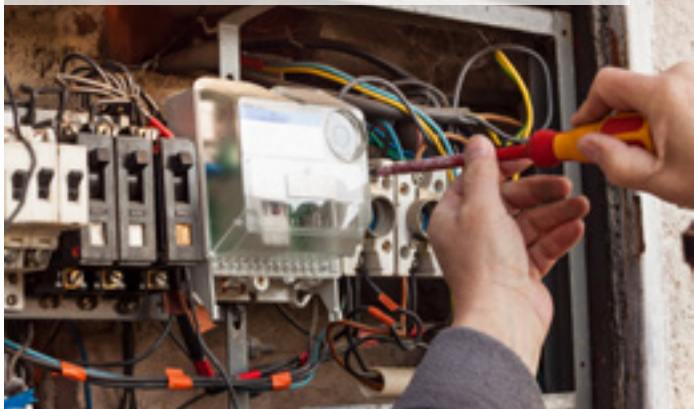
01 | Jističové prvky jednotlivých vývodů se nesmí nacházet v elektroměřové skříni
