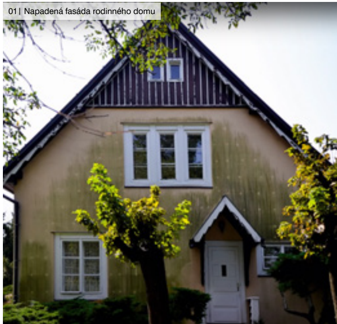
01 | Napadená fasáda rodinného domu
