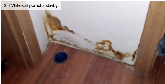
01 | Vlhkostní porucha stavby
