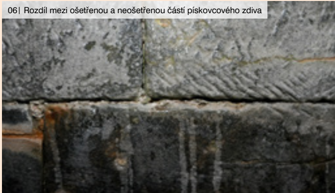
06| Rozdíl mezi ošetřenou a neošetřenou částí pískovcového zdiva
