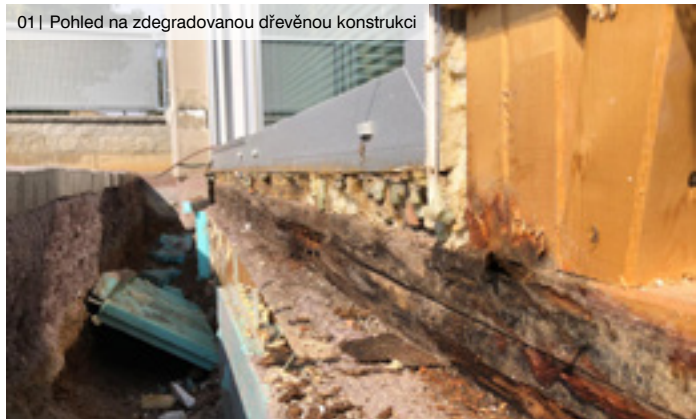
01 | Pohled na zdegradovanou dřevěnou konstrukci
