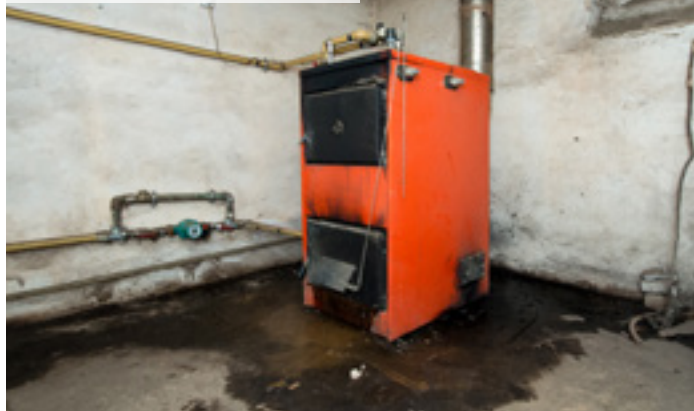
01 | Starý, nevyhovující kotel na tuhá paliva
