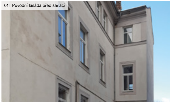
01 | Původní fasáda před sanací
