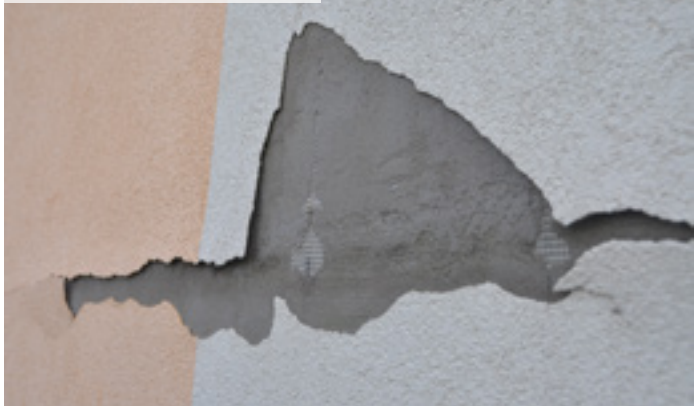
01 | Porucha vnějšího souvrství ETICS
