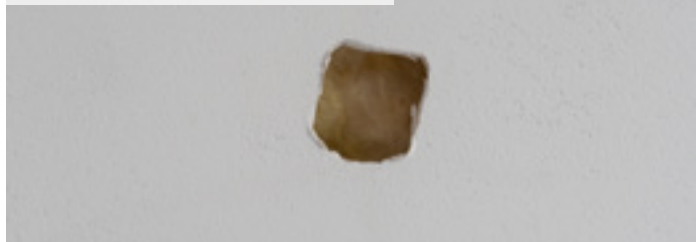
01 | Poškozené opláštění sádrokartonové stěny
