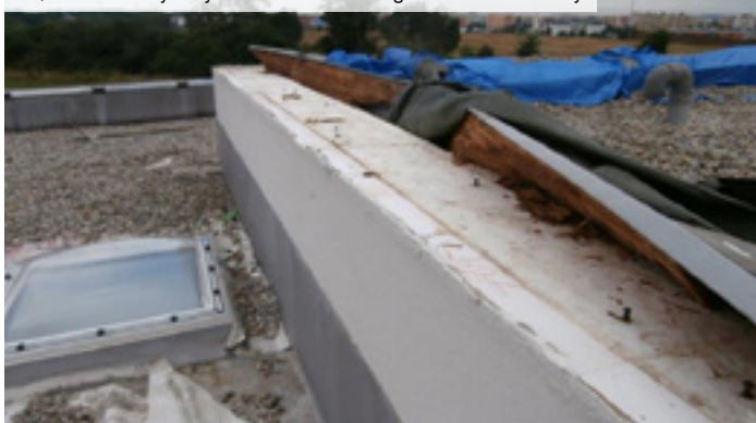
01 | Defekt koruny atiky z důvodu vlhkostí degradované OSB desky
