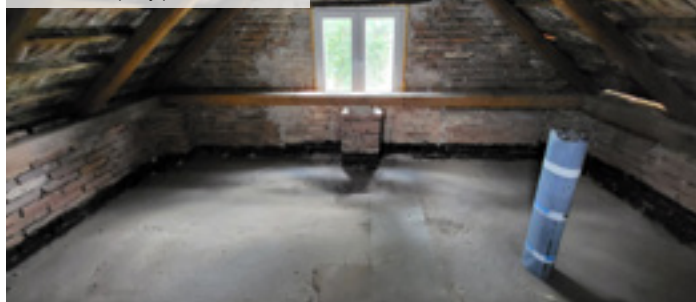
01 | Podlaha půdy před rekonstrukcí
