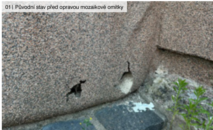
01 | Původní stav před opravou mozaikové omítky
