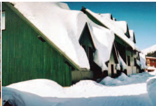
06| Extrémní zatížení střechy sněhem
