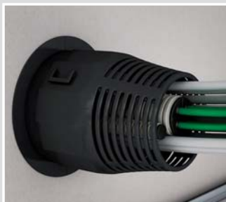
Kombinace kabelů a trubek.
