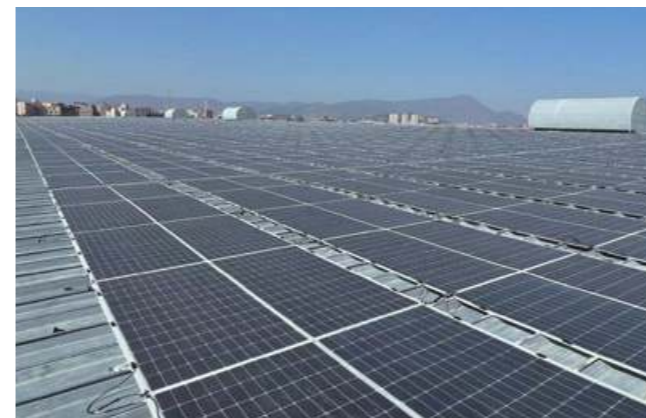
Nízká nosná střecha Provincie Fujian, Čína | 11,5 MW
