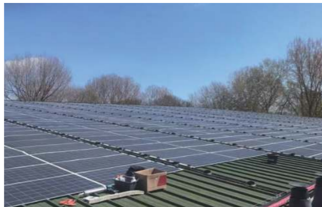
Nízka nosná strecha Nizozemsko | 1 MW
