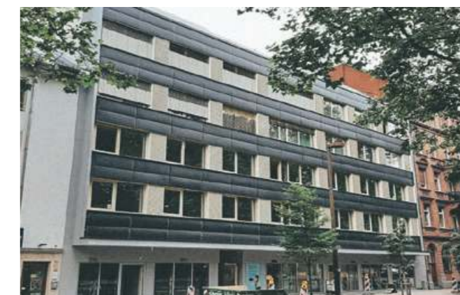
Solární fasáda Německo | 33 kW
